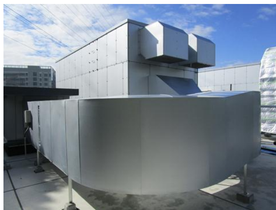
図 4: 屋上に設置されたメガクール。
